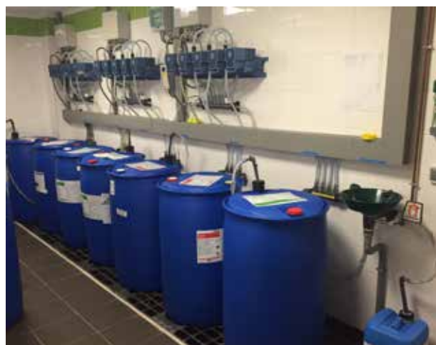
INSTALLATION TURBO PUMP POUR 5 PRODUITS ALIMENTANT 3 LAVEUSES ESSOREUSES
