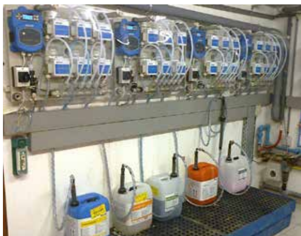
INSTALLATION SMART PUMP POUR 6 PRODUITS ALIMENTANT 4 LAVEUSES ESSOREUSES
